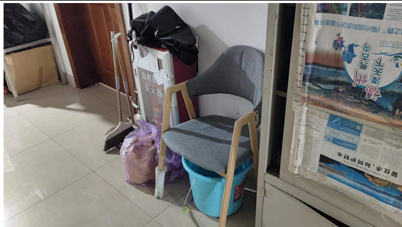
新楼三楼 灭火器旁堆放杂物
