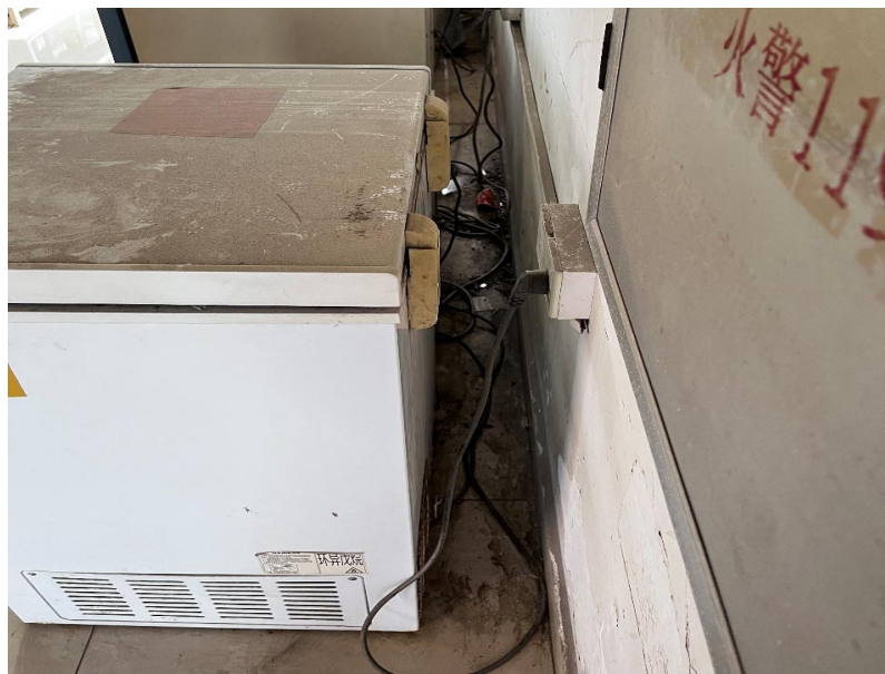
新楼四楼 电器线路杂乱
