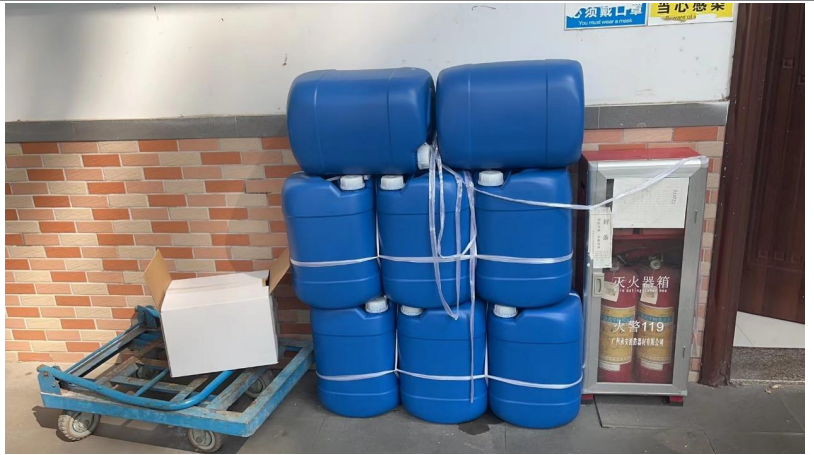
9号楼一楼 消防 栓旁堆放杂物
